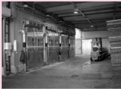
凍結室 加工された鮮魚はここで冷凍される。
